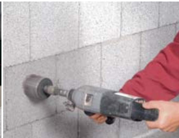
Beim Innenausbau lassen sich vollkommen problemlos Löcher bohren und die Wände auch schlitzen.
