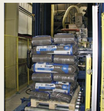
Die neue Absackanlage in Vintiřov.
