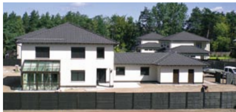
Häuser mit Liapor Super-K-Plan auf der Air Base Ramstein: Die Baumaßnahme ist von April 2006 bis Mitte 2007 geplant.
