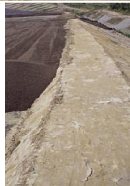
Bis zu elf Meter hoch ist der lagenweise eingebrachte Liapor-Straßendamm, der beidseitig von Erdwällen eingefasst wird.
