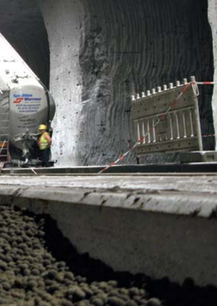
Die Liapor Blähtonkörnung bietet statische Sicherheit im Spalt zwischen Bunkerwand und Salzvorkommen.
